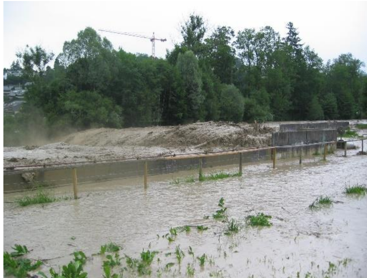
Überflutung der Müllerschwelle beim Hochwasser vom 4. Juli 2012
