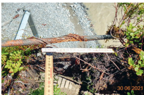
Bei einer Kontrolle wurden Schäden an den Tragsäulen festgestellt.
