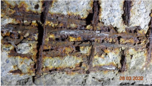
Abbildung 3, freiliegende und durchgerostete Armierung
