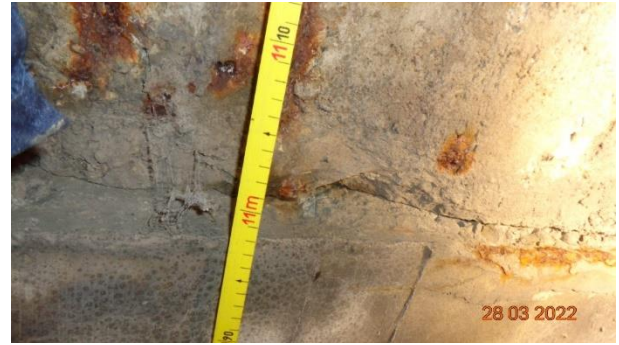
Abbildung 2, Betonabplatzungen mit Korrosionsspuren
