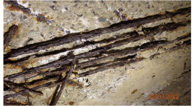
Abbildung 4, Betonabplatzungen und freiliegende Armierung
