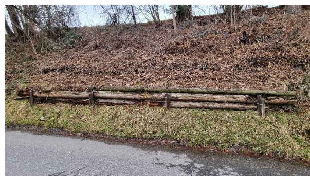
Abbildung 5: Zustand bergseitige Hangsicherung
