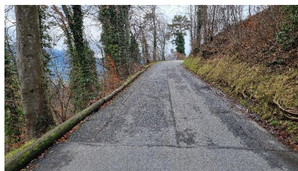
Abbildung 3: Allgemeinzustand oberer Abschnitt
