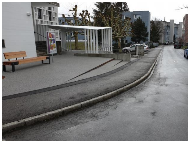
Abbildung 4: Risse entlang Randabschluss
