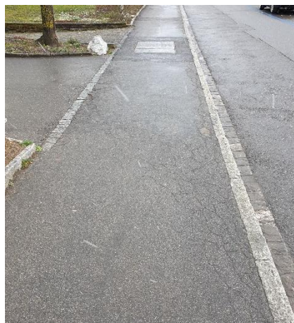
Abbildung 5: Risse in Gehweg
