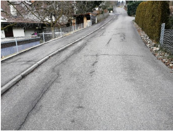
Risse und leichte Deformation der Strassenoberfläche
