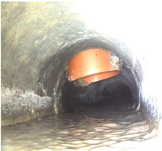
Verkalkte Saubwasserleitung mit nicht fachmännisch ausgeführtem Anschluss
