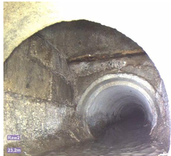
Schadhafter, überdeckter Kontrollschacht der Saubwasserleitung
