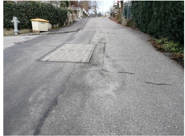
Starke Deformation der Strassenoberfläche
