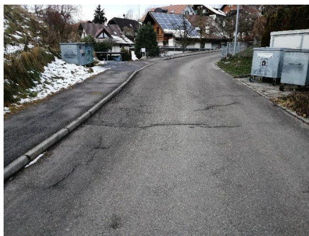
Allgemeinzustand unterer Strassenabschnitt
