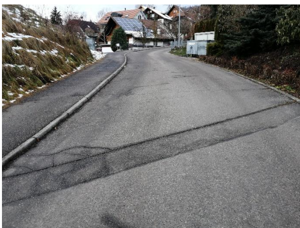
Risse im Bereich eines Werkleitungsgrabens
