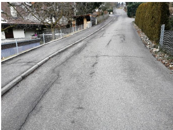
Risse und leichte Deformation der Strassenoberfläche
