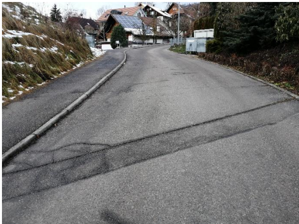
Risse im Bereich eines Werkleitungsgrabens
