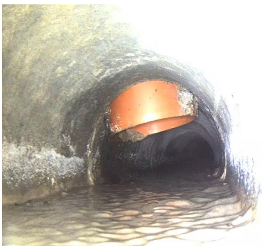
Verkalkte Sauberwasserleitung mit nicht fachmännisch ausgeführtem Anschluss
