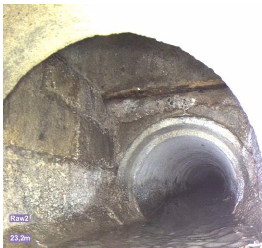
Schadhafter, überdeckter Kontrollschacht der Sauberwasserleitung
