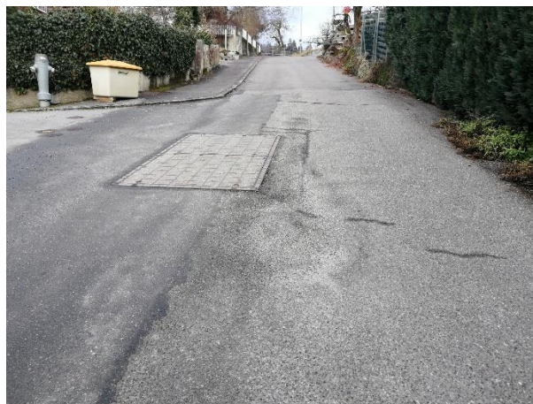
Starke Deformation der Strassenoberfläche
