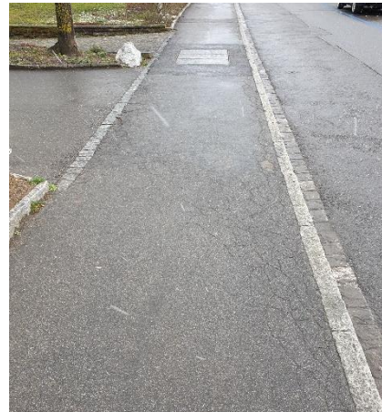
Abbildung 5: Risse in Gehweg
