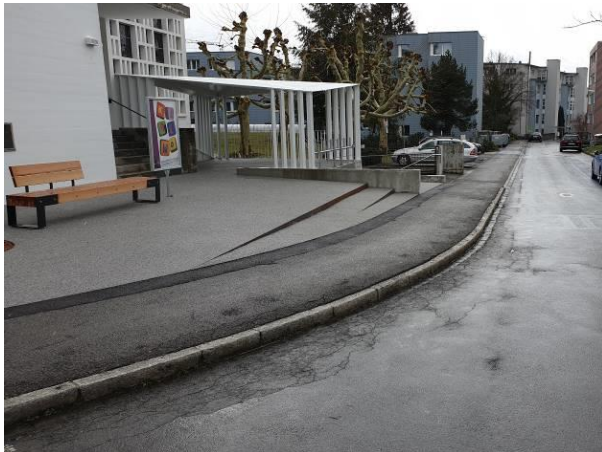
Abbildung 4: Risse entlang Randabschluss
