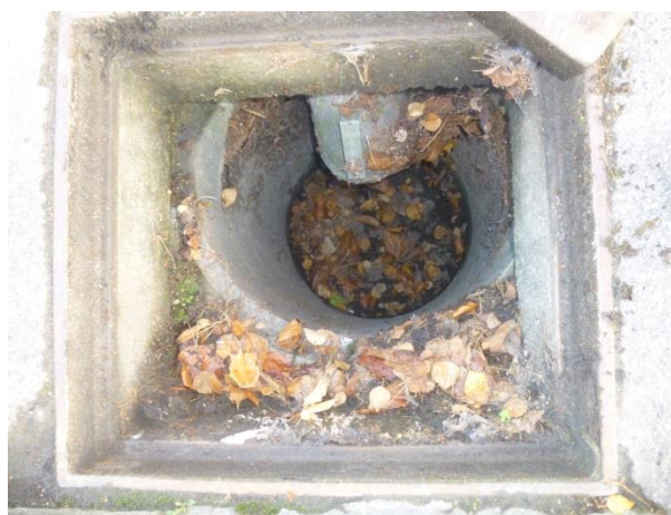
Abbildung 5; Schlammfänger undicht, Abdeckung schlecht versetzt
