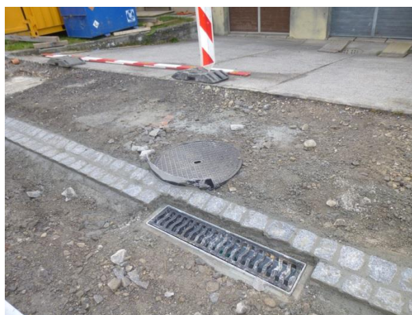
Abbildung 10; Neuer Einlauftrög mit Schlammsammler, Beispiel Schlosstrasse
